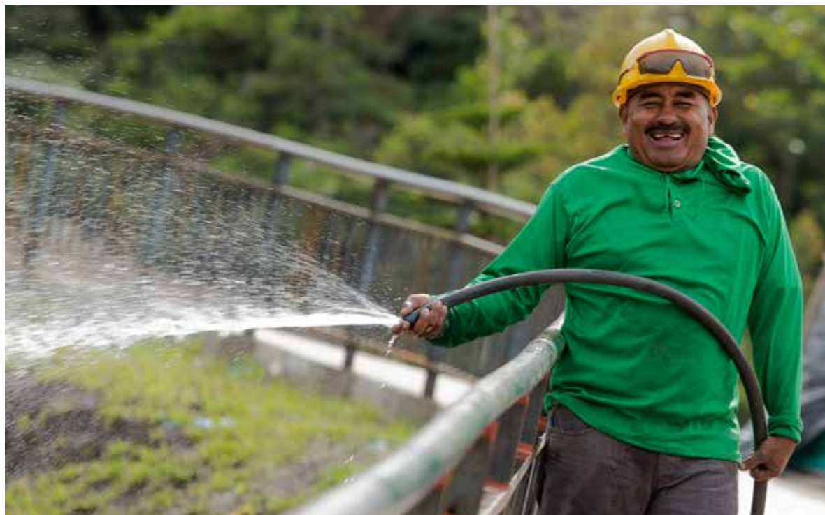
→ Uno de los trabajadores que se ocupa de obras de ornamentación y paisaje en la construcción del Nuevo Gramalote.
